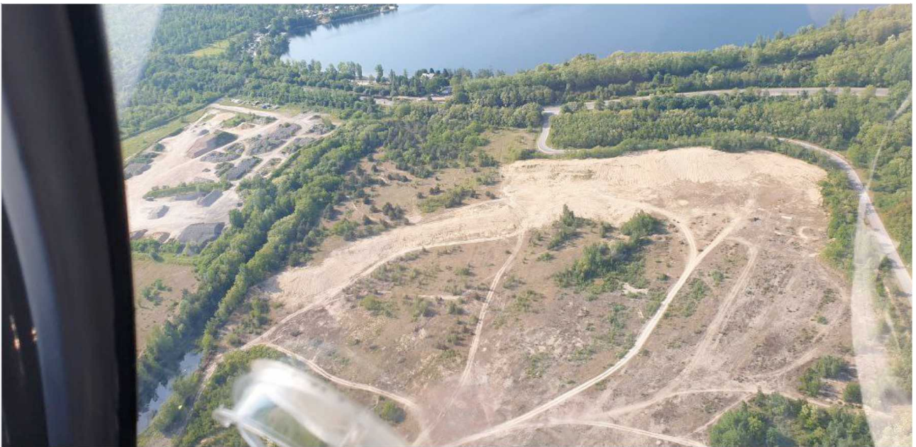
2023, nach den Böschungsarbeiten, eigene Aufnahme, Vordergrund durch Verzerrung etwas zu groß im Vergleich zum Hintergrund
